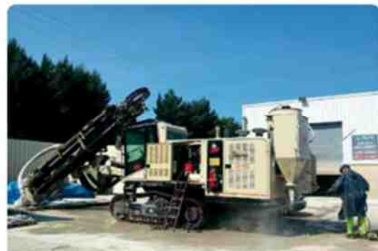
■ Aire étanche de ravitaillement, d'entretien et de nettoyage reliée à un décanteur-déshuileur
