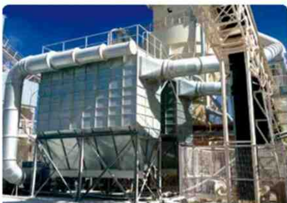
■ Système d'aspiration centralisée, filtres à manches
