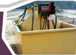
■ Cuve carburant mobile sur rétention
