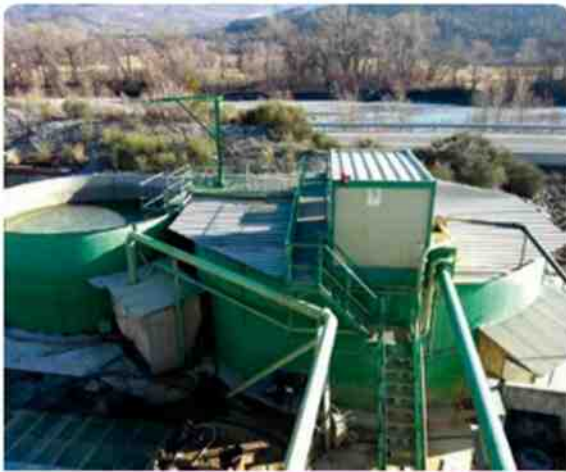
■ Recyclage des eaux de process avec clarificateur
